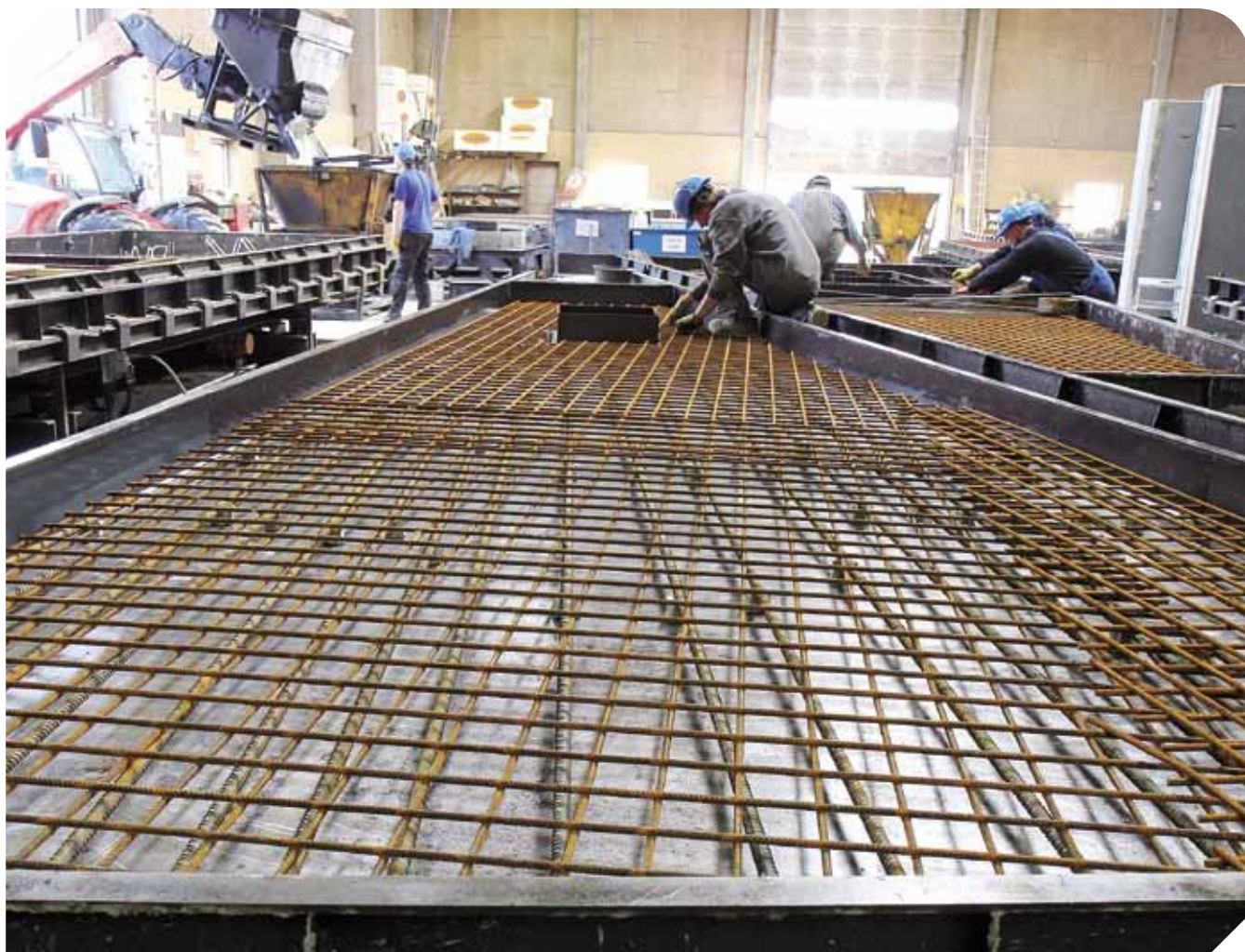
Produktion af trekantede dækelementer til tankene i et biogasanlæg.
